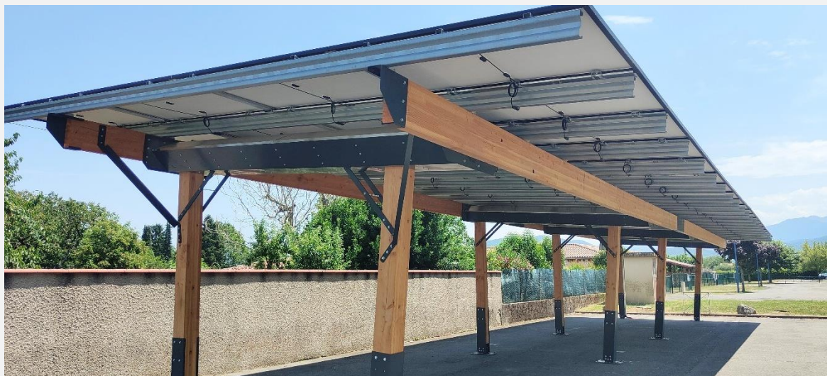
L'ombrière photovoltaïque en autoconsommation installée sur le parking de la salle des fêtes de Pointis-de-Rivière, d'une puissance de 35,8 kWc, permet de fournir de l'électricité à plusieurs bâtiments situés à proximité : l'école, la salle des fêtes et la salle des sports.
